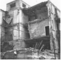
• Pare Foggia caduta
